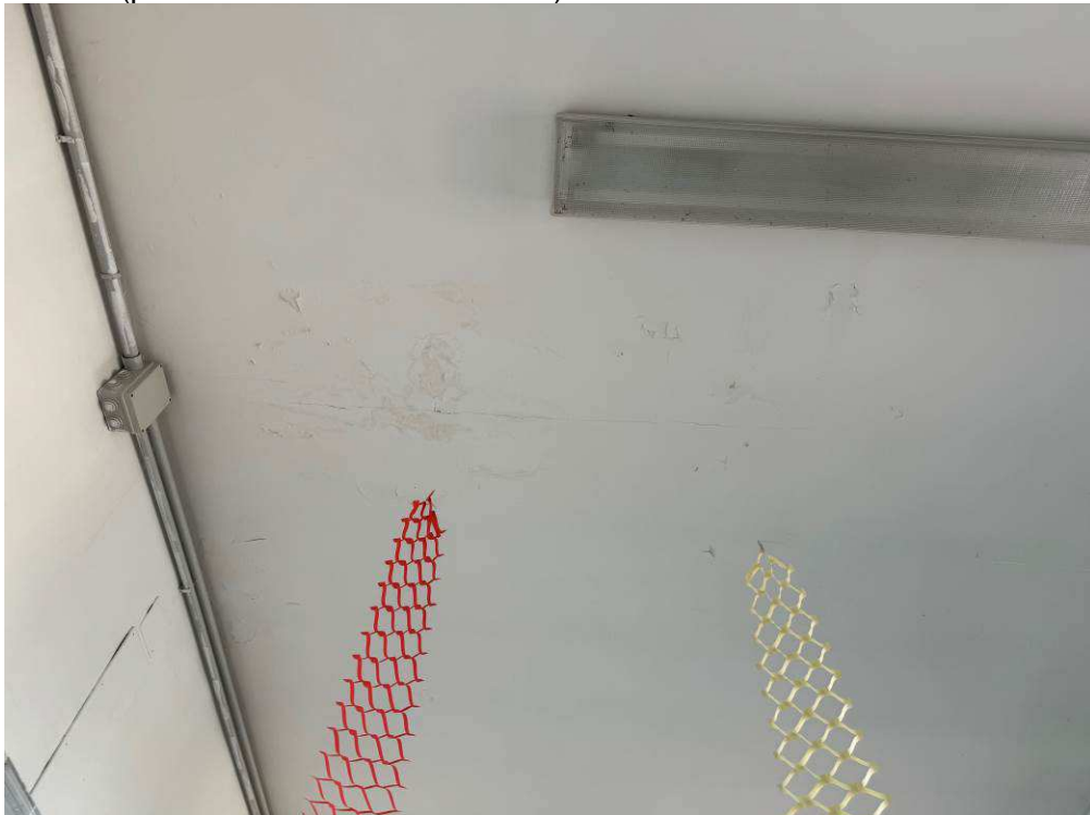
Foto n°6 (presenza di lesioni sul soffitto)
