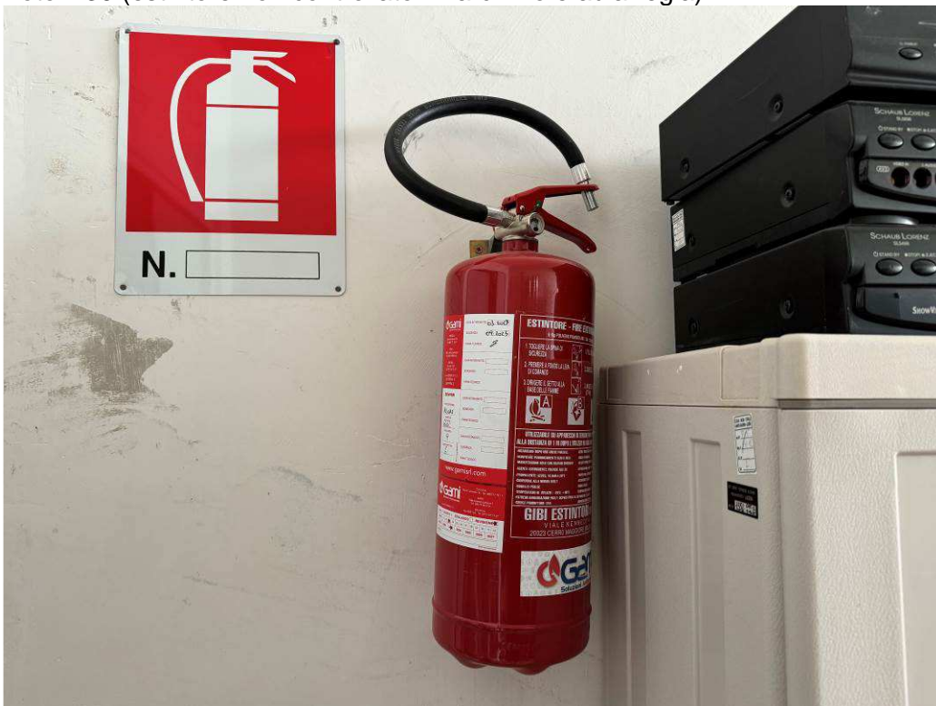
Foto n°30 (estintore non controllato in archivio e aula regia)
