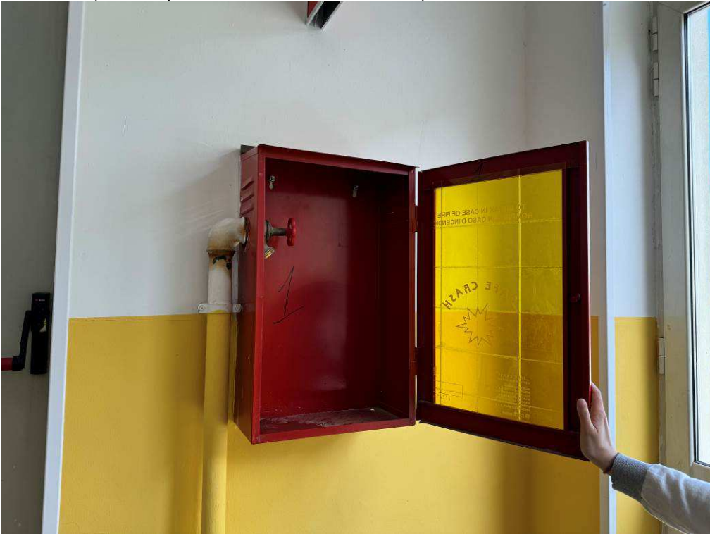
Foto n°29 (idrante privo di manichetta e lancia)
